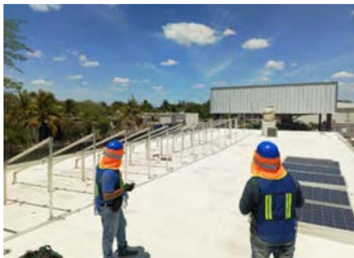
Sistemas de generación de energía solar, Aeropuerto de Mérida
